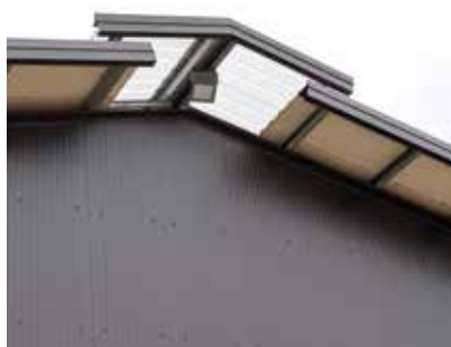
Una soluzione è una fessurazione lungo la linea di colmo del tetto (Lastaben, 2020).
